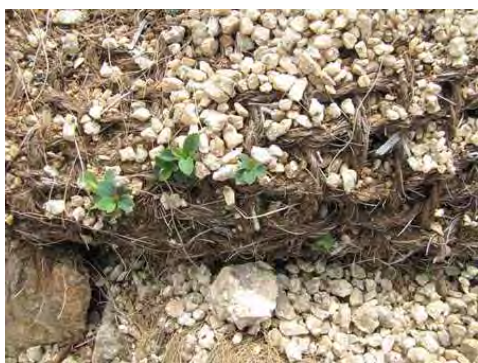
【ヤシ土嚢への植物の侵入状況】
